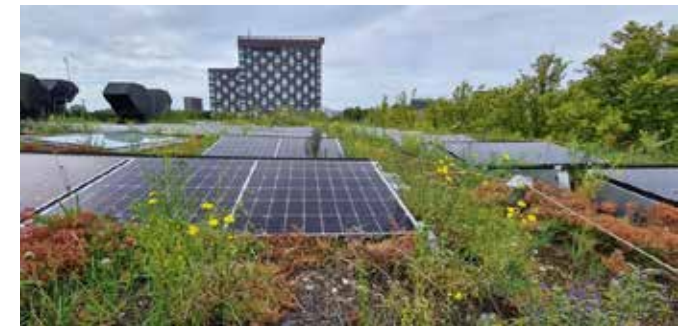
Referentiefoto: zonnepanelen op een sedum dak (30)
