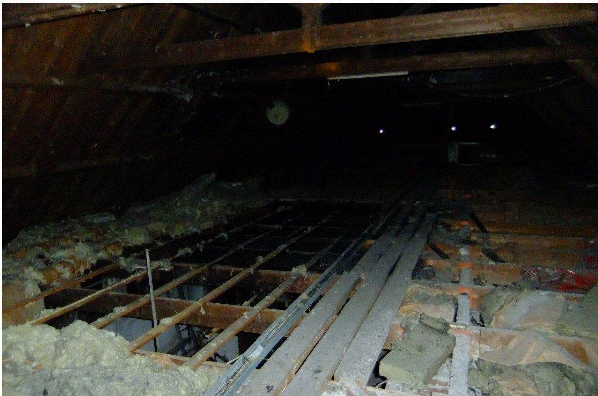
Brandschade aan houten balklaag zolder.
