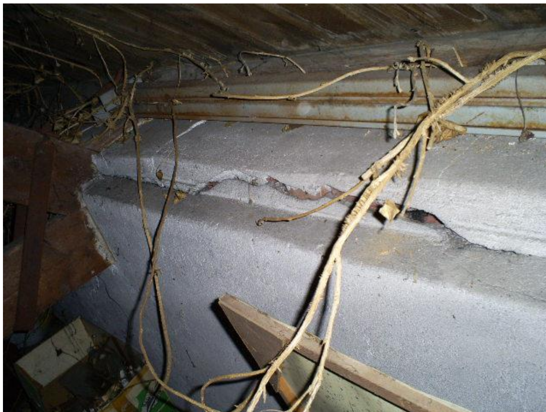
Muurplaat verankering aan metselwerk los gescheurd hedra die naar binnen groeit
