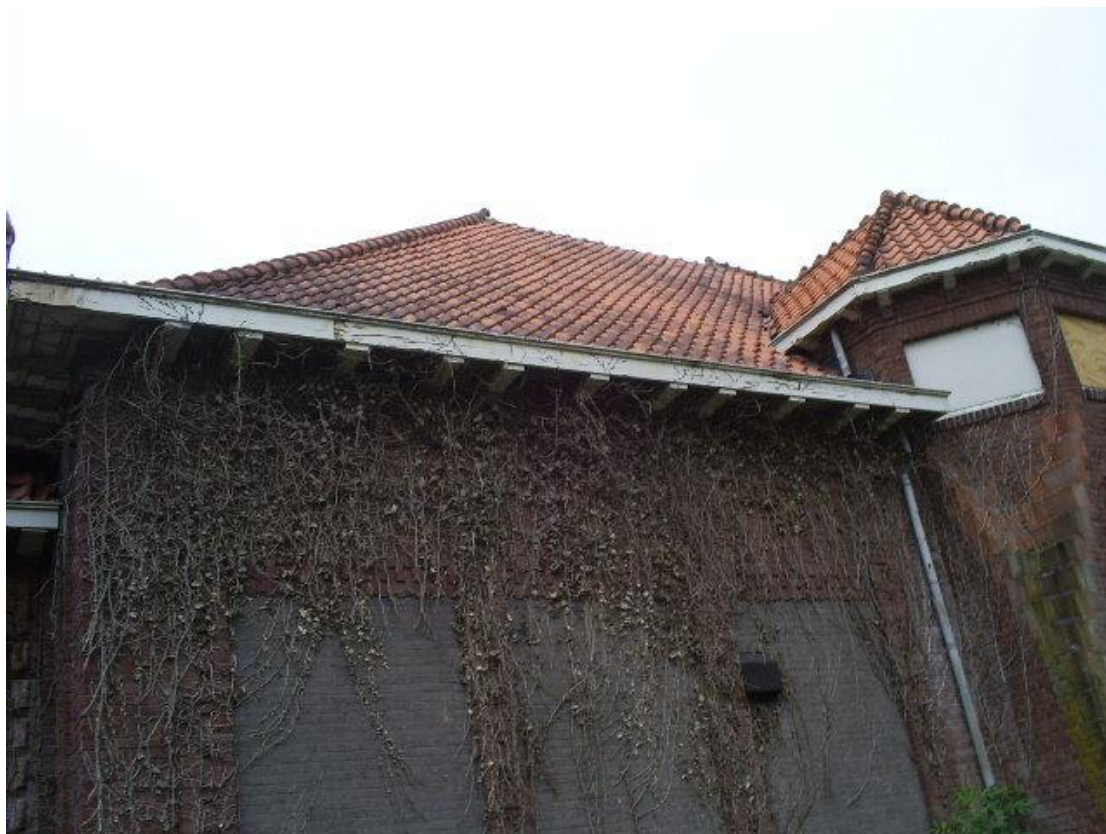
Gevel begroeid met hedra en boeidelen gootconstructie schilderwerk slecht van kwaliteit en lekkage plekken vanwege lekkage goot links.
