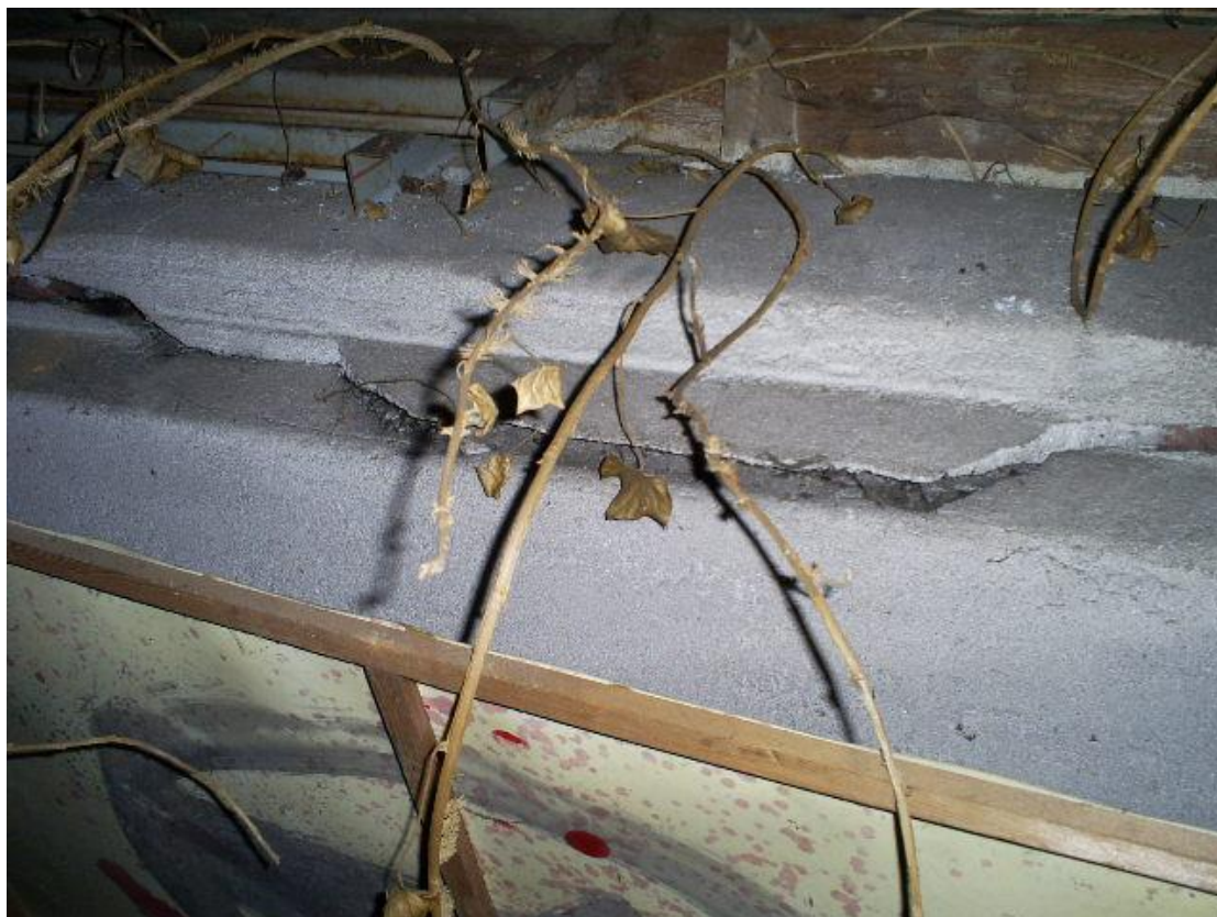
Muurplaat verankering los gescheurd.
