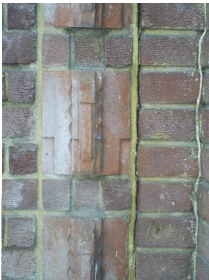
Scheurvorming metselwerk tussen het linker bouwdeel en middendeel op plint niveau
