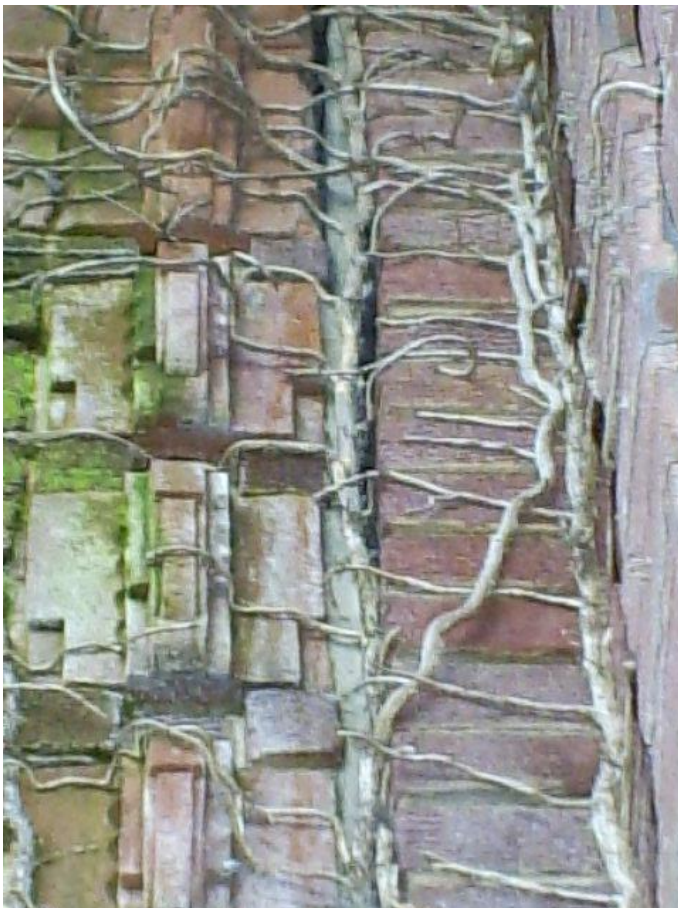
Scheurvorming tussen linker bouwdeel en middendeel onder goot constructie gelegen. Scheurvorming naast hedra circa 25mm.
