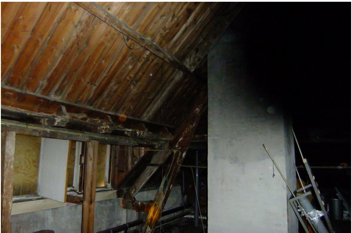
Lekkage plekken rond dakkapel
