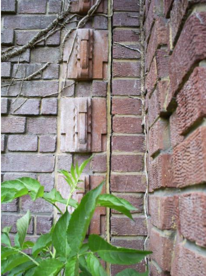
Scheurvorming tussen linker bouwdeel en middendeel hoger gelegen. De scheurvorming wordt groter
