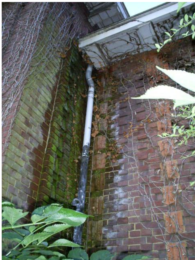
Lekkage gootconstructie en hwa
