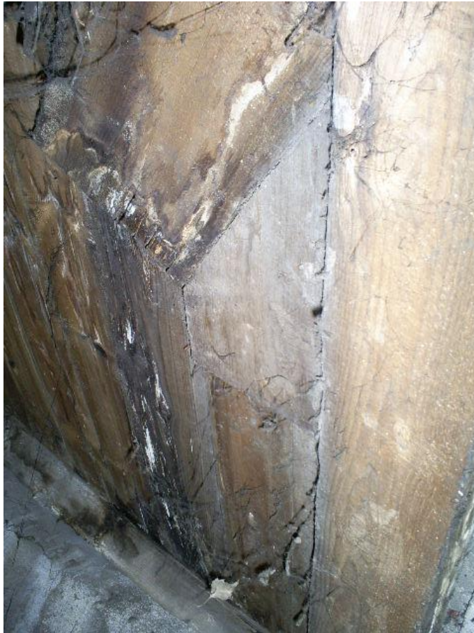
Slechte stukken dakbeschoot
