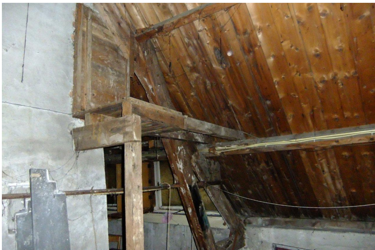
Lekkage dakconstructie sporen van aantasting kaspant.
