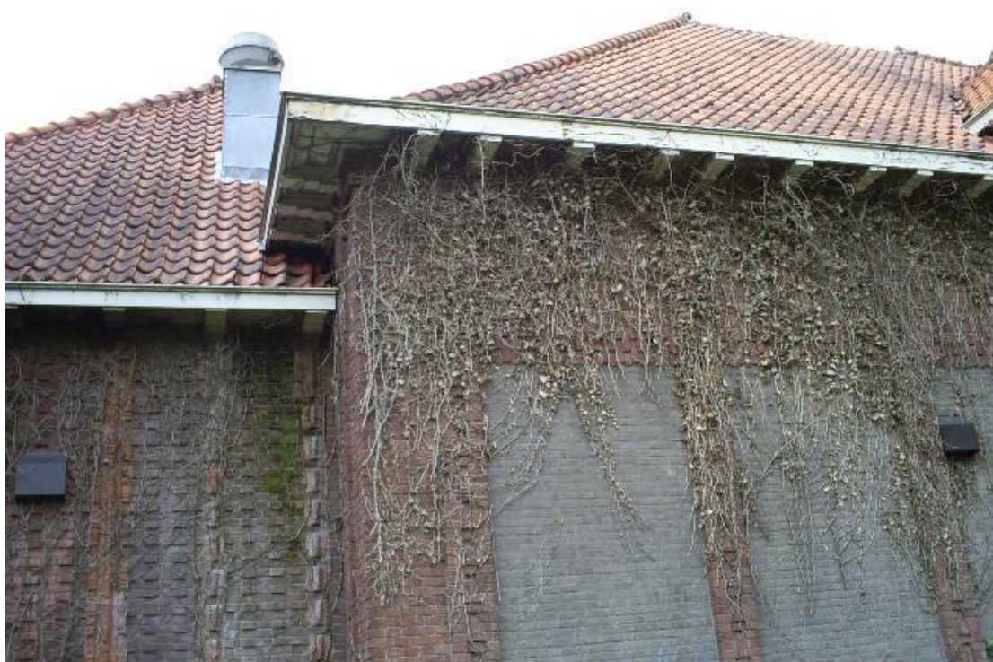
Gevel begroeid met hedra en boeidelen gootconstructie schilderwerk slecht van kwaliteit en lekkage plekken in gevel vanwege lekkage goot constructie
