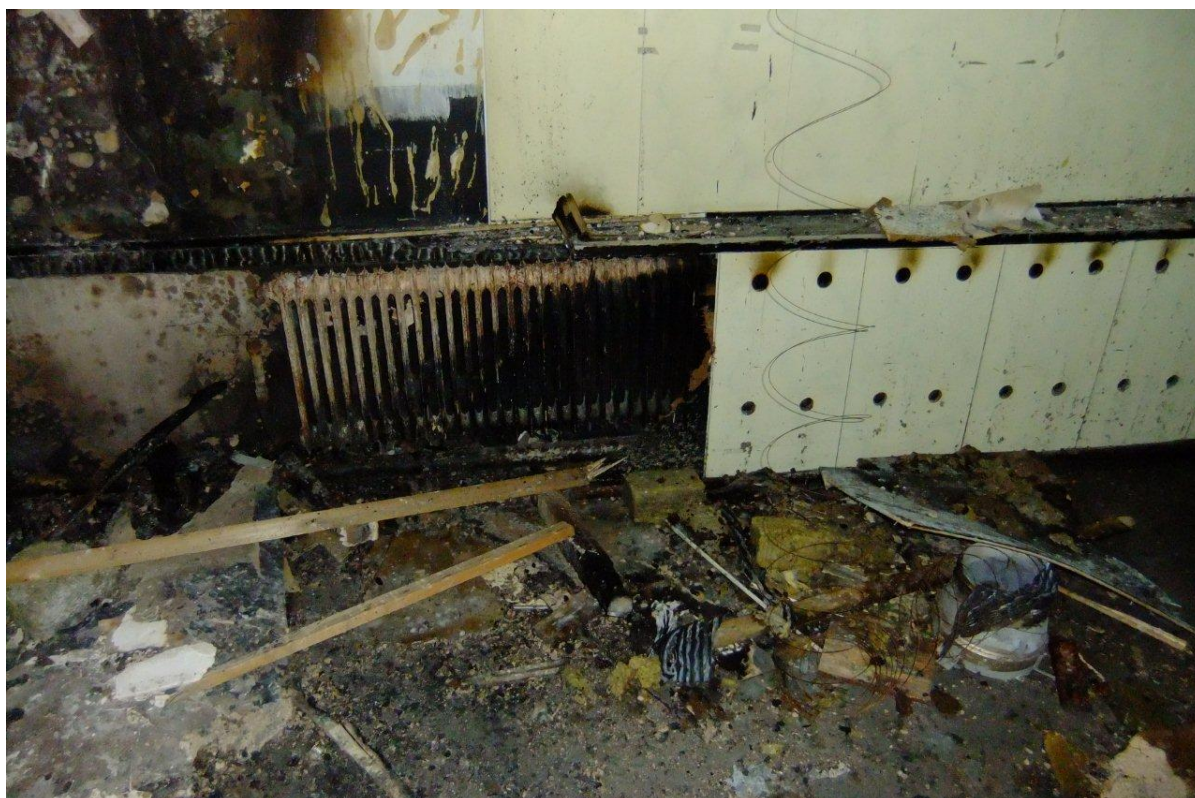
Brandschade linker bouwdeel
