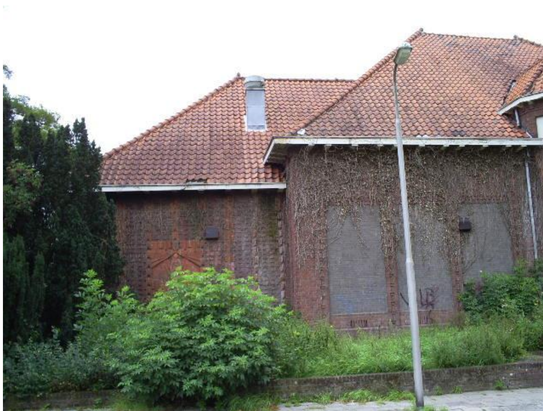
Gevel begroeid met hedra en boeidelen gootconstructie schilderwerk slecht van kwaliteit. Onderst rij dakpannen deels niet meer aanwezig
