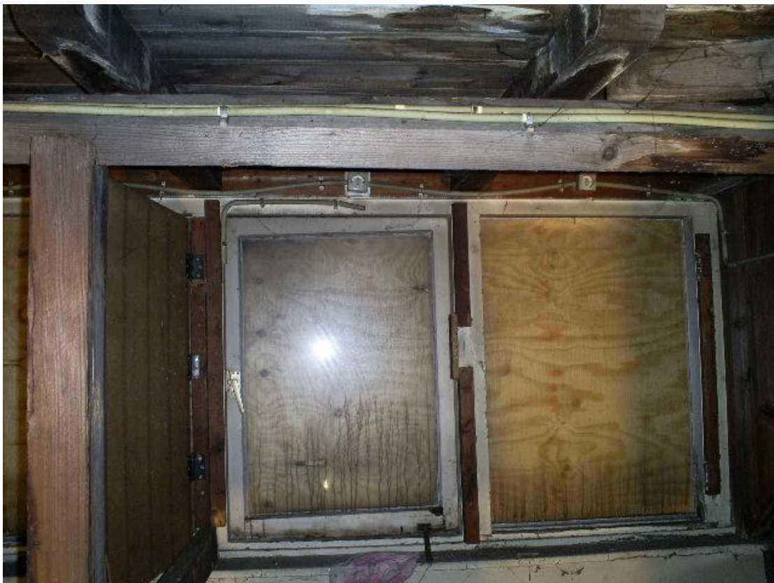
Kozijn /raam dakkapel uitgezakt in slechte staat
