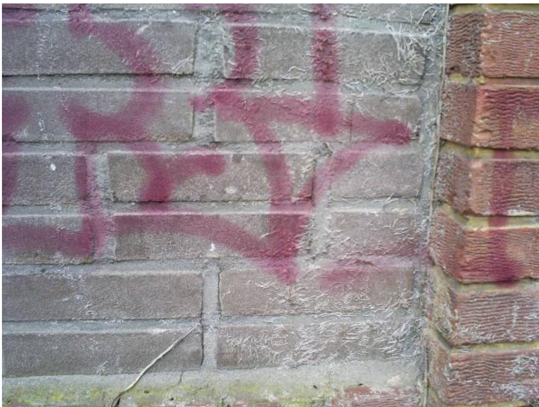
Scheurvorming in later aangebracht metselwerk van voormalige raam sparingen
