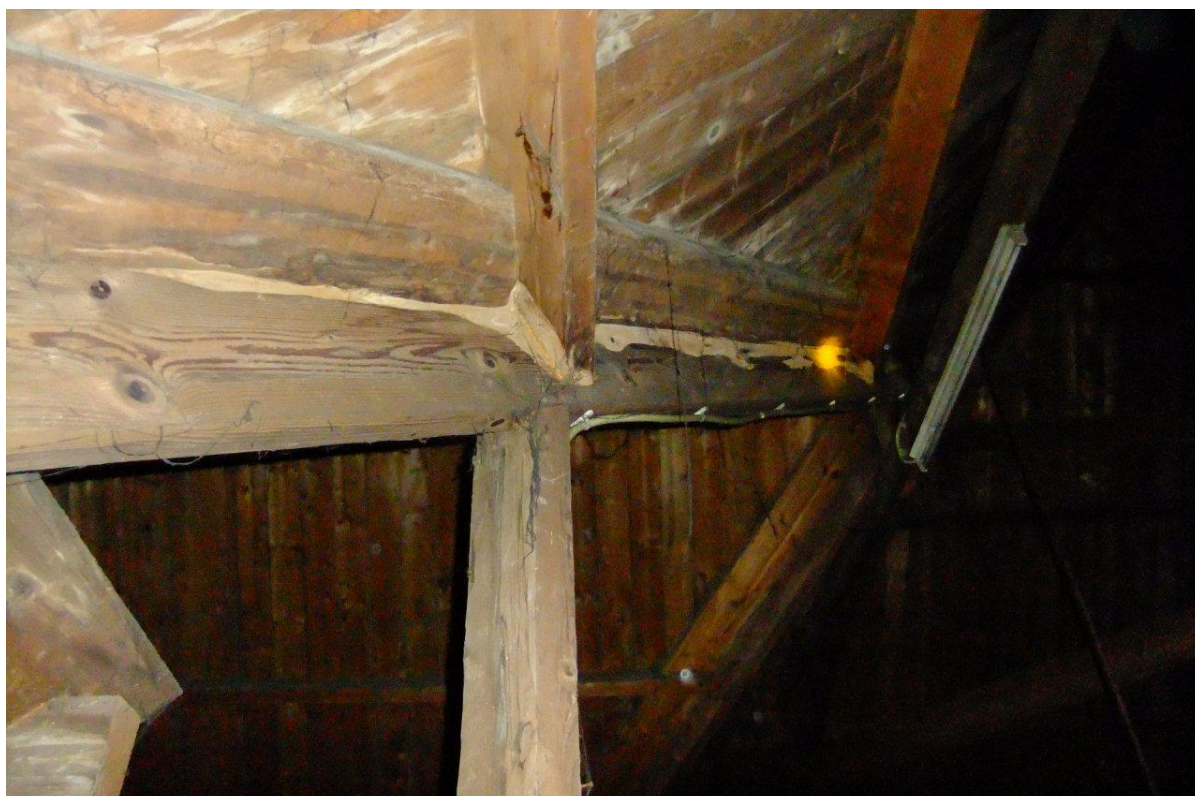
Aantasting door Zwam en lekkage sporen in kapconstructie
