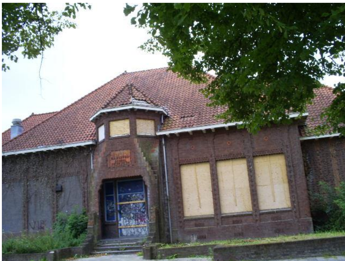
Dakpannen bedekking deels niet meer aanwezig ter plaatsen dak entree en rechts naast entree
