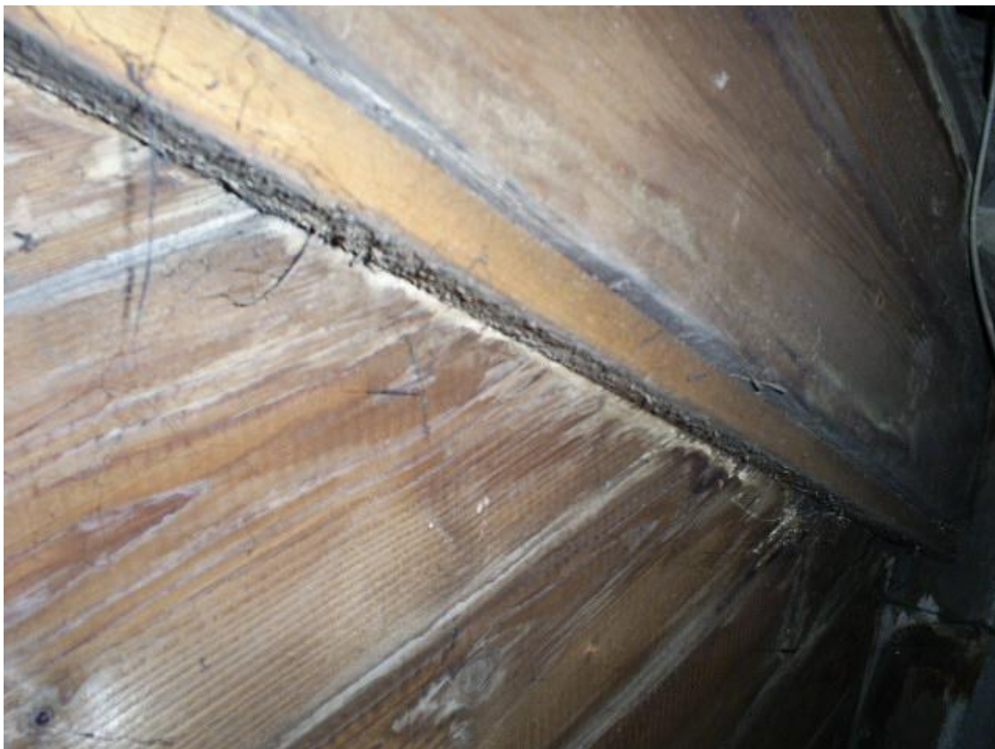
Lekkage sporen bij hoekkeper balk
