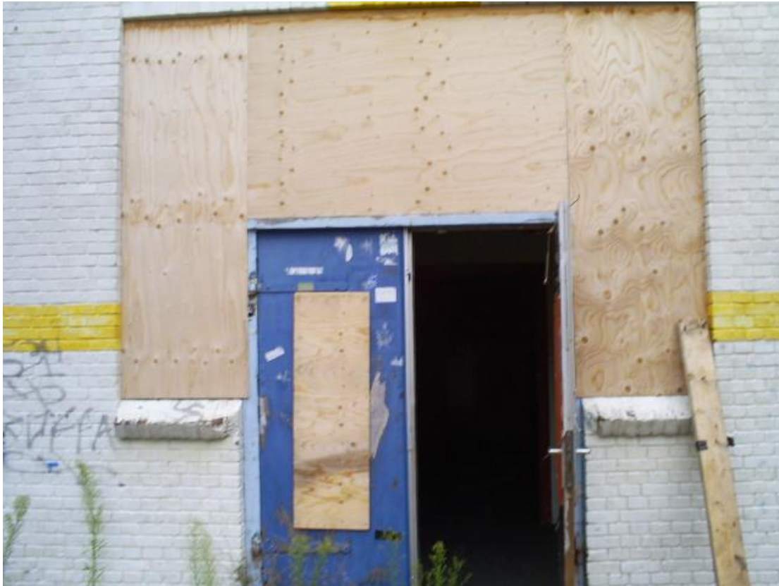
Gevelkozijnen en deuren zijn plaatselijk dicht gespijkerd en vernield.
