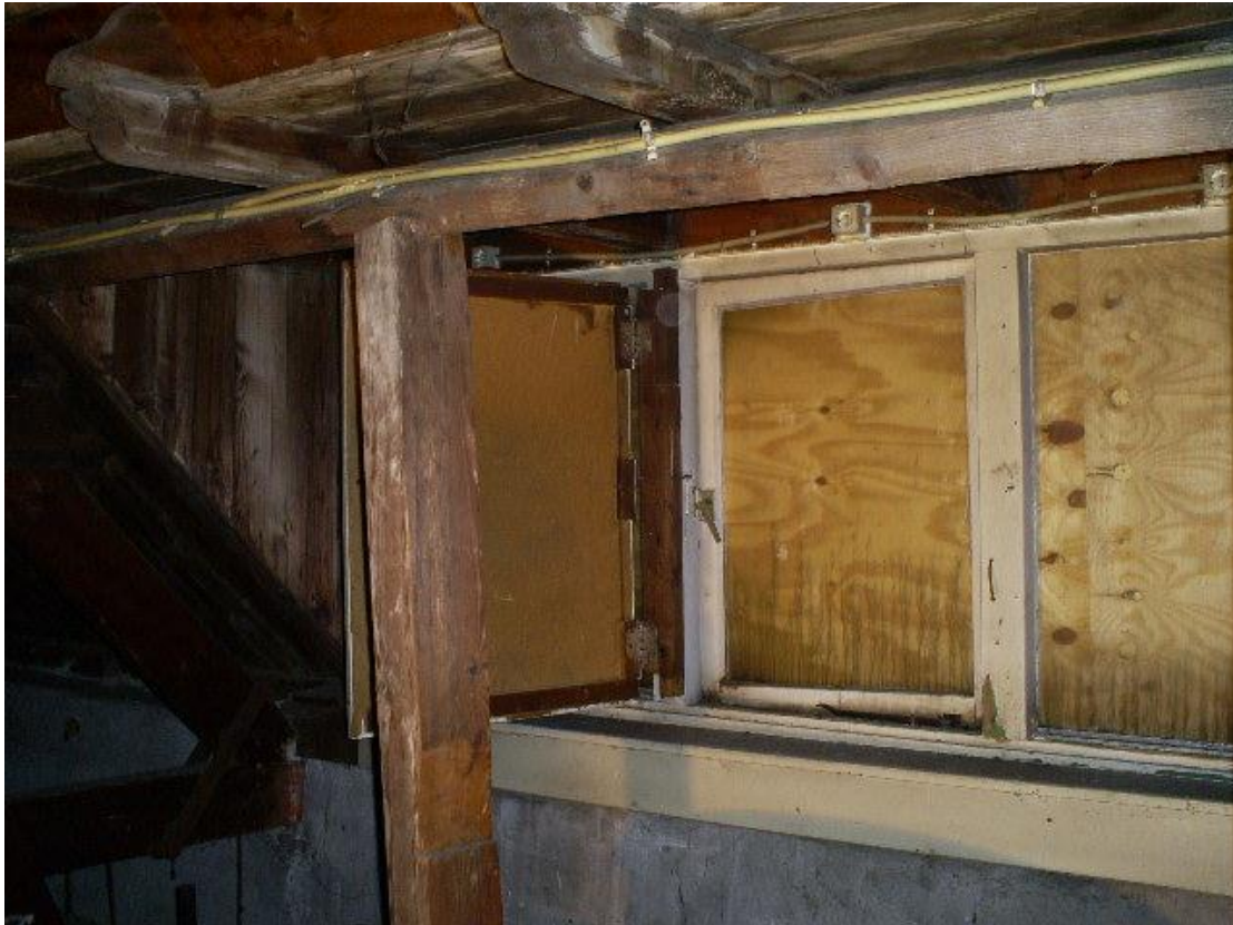
Meerdere lekkage sporen in constructie dakkapel en staander dakkapel.
