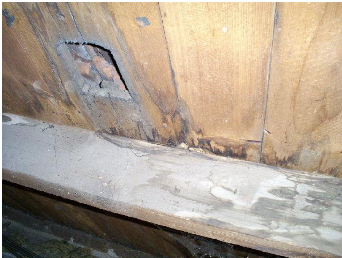
Dakbeschot aangetast, lekkage sporen zichtbaar.
