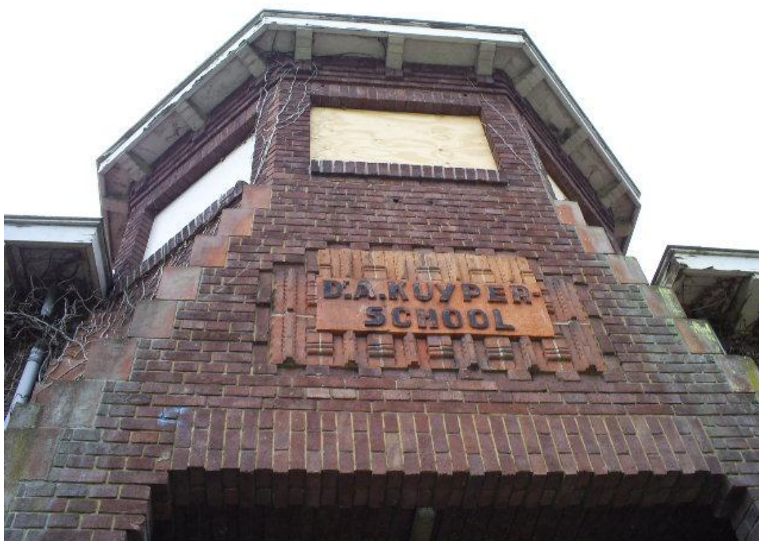
Schilderwerk boeidelen en gootconstructie in slechte staat
