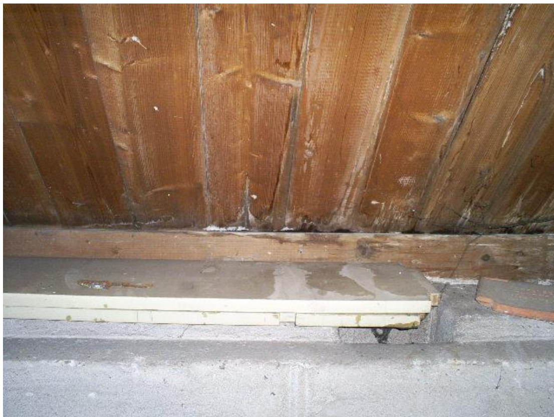
Slechte stukken dakbeschot ter hoogte van muurplaat en plaatselijk slechte stukken muurplaat
