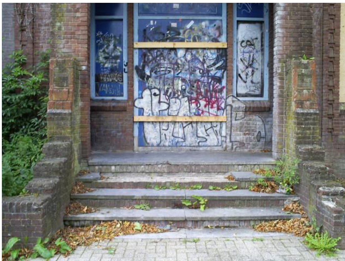
Natuurstenen traptrede stuk, liggen los en deels niet meer aanwezig
