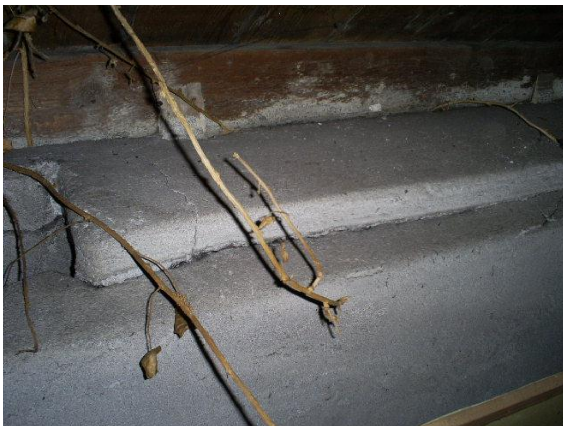
Muurplaat verankering los gescheurd
