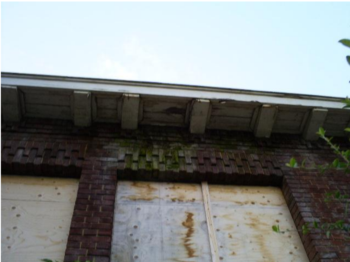
Gootconstructie aangetast gootklossen / gootbodem
