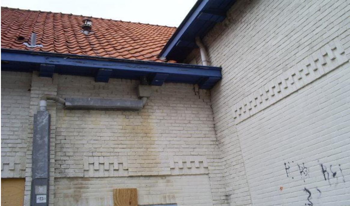
Gootdelen schilderwerk in slechte staat en scheurvorming in het gevelmetselwerk rechts onder goot
