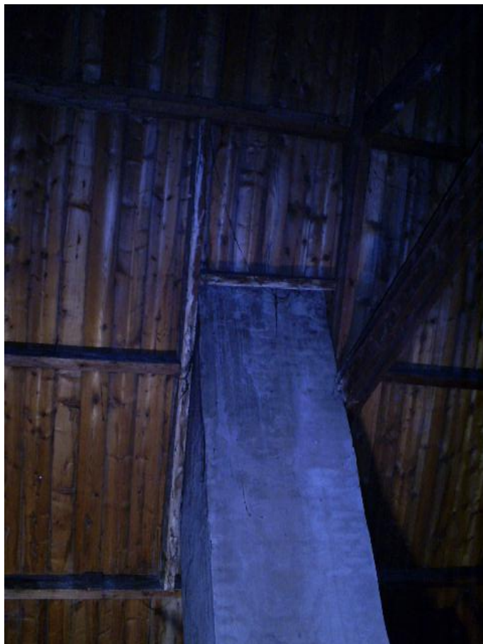
Lekkage sporen rond schoorsteen doorvoering
