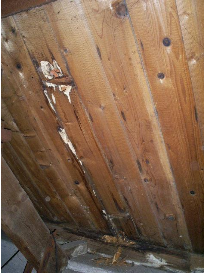
Slechte stukken dakbeschoot als gevolg van lekkage.
