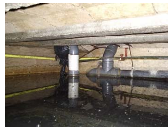
Water in kruipkelder
