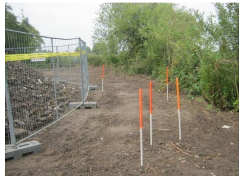
Foto 6: Puindepot en ligging asbestplaatjes op maaiveld, aangegeven met sjalonstokken
