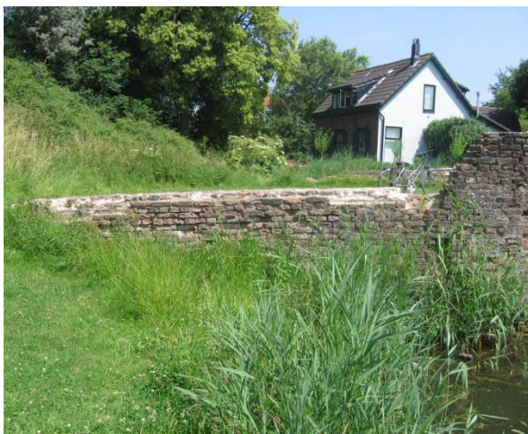
Weggezakt deel van de westmuur;
