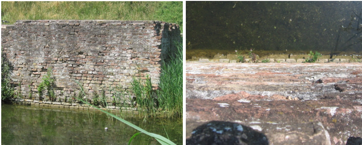
Uitgespoeld voegwerk en begroeiing op het muurwerk langs de waterlijn, vanuit westen en van bovenaf gezien
