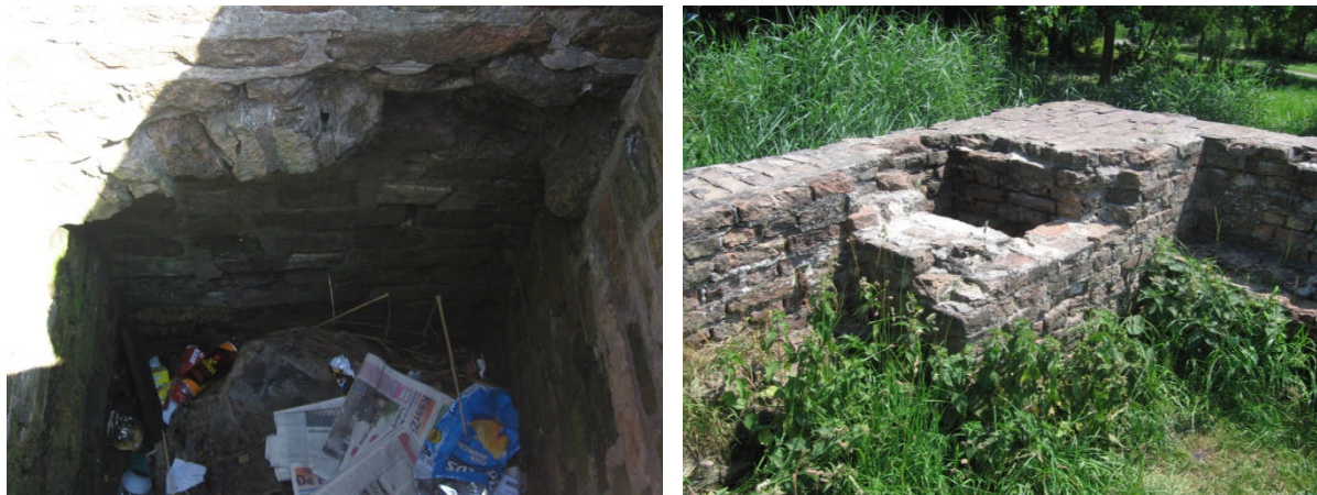
Binnenzijde beerput vervuild met zwerfafval, stenen rollaag beschadigd; afdekkingen beerput beschadigd
