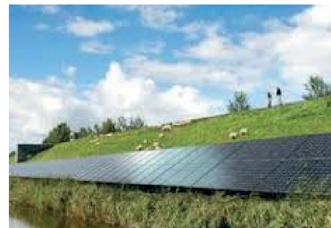
Zonnepanelen op de geluidswal. in combinatie met agrarisch medegebruik
