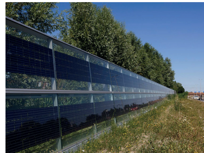
Pijnacker: zonnepanelen in de geluidswering
