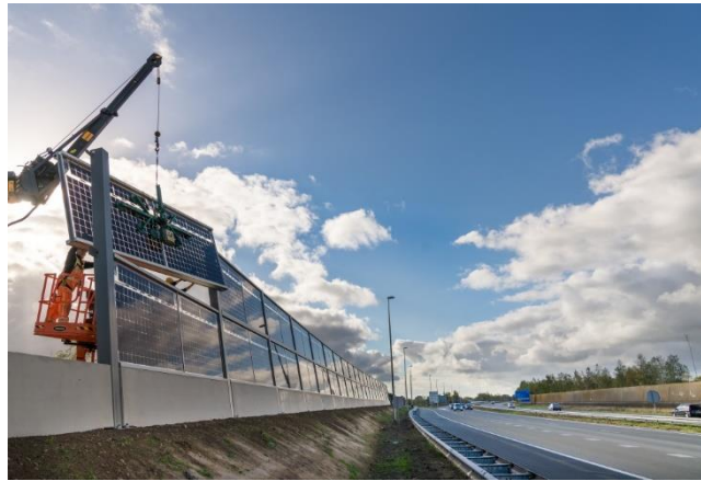
Voorbeeld van zonnepanelen aan een geluidsscherm in Italië (bron: Google Maps). En een voorbeeld van zonnepanelen in het scherm (TNO Solar Highways.).
