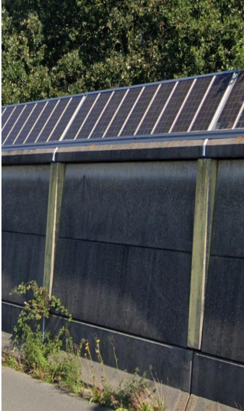
Voorbeeld van zonnepanelen op geluidsscherm, A27 Utrecht
