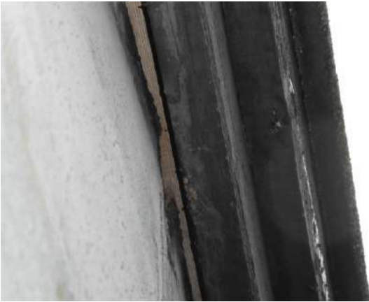
Figuur 22 Daktrim schuur, geen ruimte
