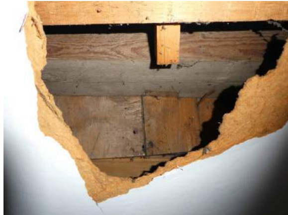
Figuur 21 Gat plafond woning
