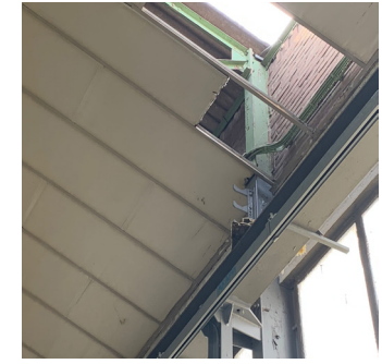
12. Staalconstructie en metselwerk zichtbaar door de gaten in het plafond.
