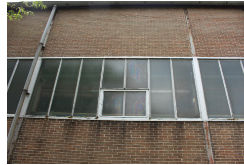
7. Oorspronkelijke staalconstructie met metselwerk invulling en vensters met stalen kozijnen. Op sommige plekken is de gevel aan de binnenzijde versterkt met stalen tussenstukken.
