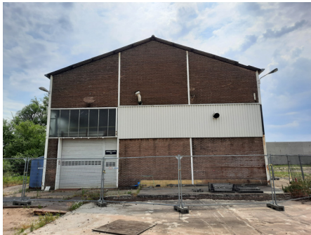
5. Noordgevel: de vensters zijn hier met witte stalen platen dichtgezet. De oorspronkelijke toegangsdeuren zijn vervangen door een garagedeur.
