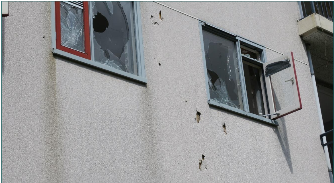
Figuur 3.2 De gevels van het westelijk gelegen woonblok zijn intacter dan het oostelijk gelegen woonblok. Er zijn openingen aanwezig in de gevelbeplating die kunnen leiden naar mogelijk geschikte plekken voor vleermuizen.
