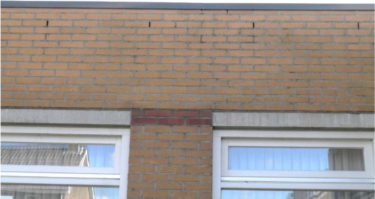
Figuur 5. Open spouwvoegen boven de ramen in de gevel langs de Bizetstraat.
